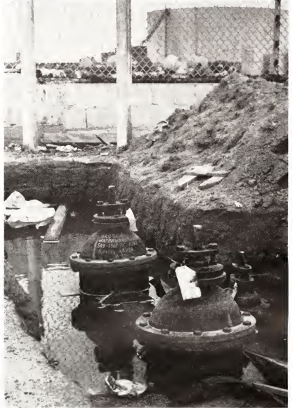
De afsluiters in de 8 duim leiding van Balashi naar de Lago op de plaats waar deze het Lago terrein binnen gaat.
